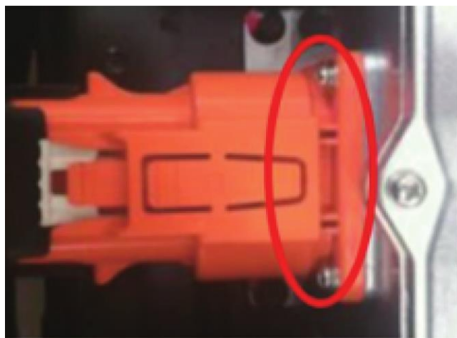
高压插件未装配到位
